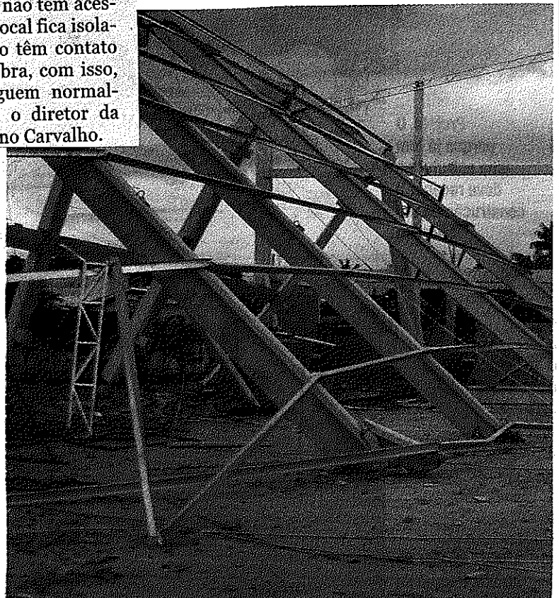
Falha humana. Tirantes malcolocados fizeram a estrutura do ginásio desabar
