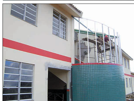
Com as obras, a EEB São José terá capacidade para atender 2.700 alunos
